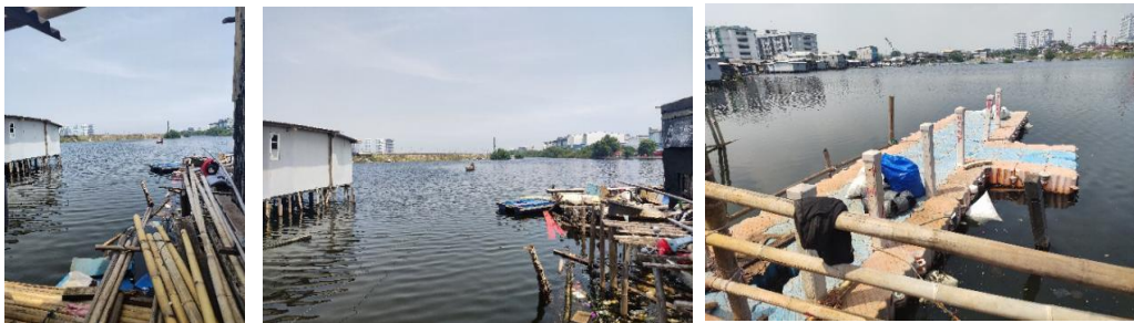
Gambar 4. Akses menggunakan perahu bagi nelayan yang tinggal di Kampung Pojok menuju kapal yang berada di seberang tanggul NCICD. Akses jembatan sudah rusak diterjang ombak banjir rob.
